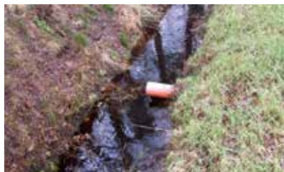
In das Gewässer hinein ragende Bauteile verursachen Stau, Auskolkungen, behindern den Abfluss und die maschinelle Unterhaltung.
