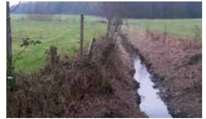
Erschwerte Unterhaltung durch in das Gewässer ragende Einzäunung.
