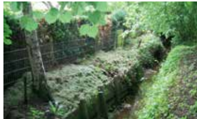
Gartenabfälle erschweren die Unterhaltung und führen zu instabilem Untergrund.
